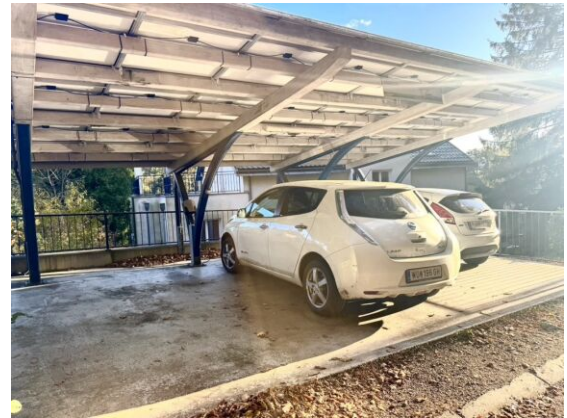
Carport mit Solarpanels
